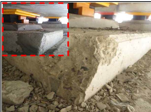
교각 P2 받침콘크리트 파손(보수완료)
