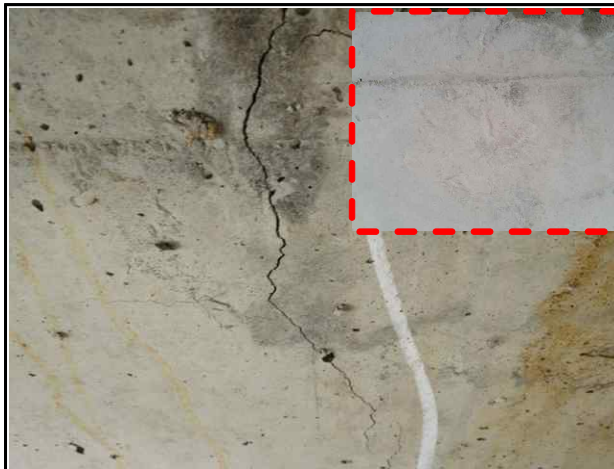
교각 균열(폭 0.3mm)(보수완료)
