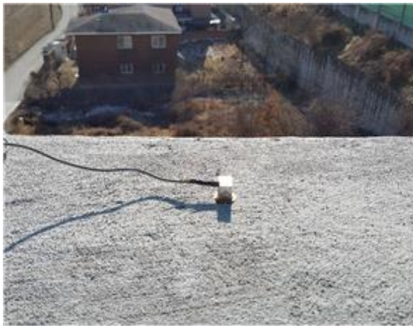
가속도계 설치 현황
