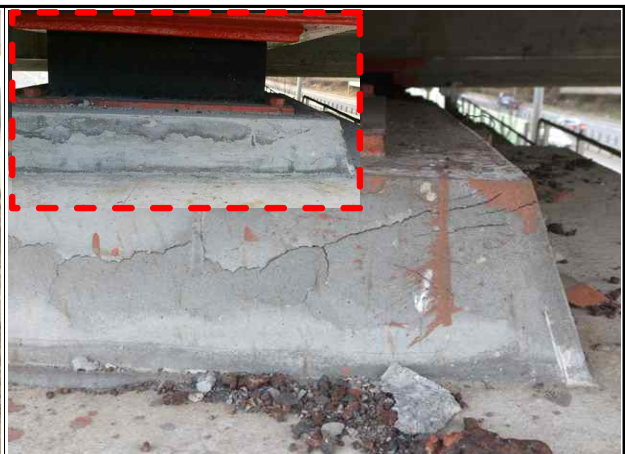
교각 P2 받침몰탈 균열(폭 0.3mm미만)(보수완료)
